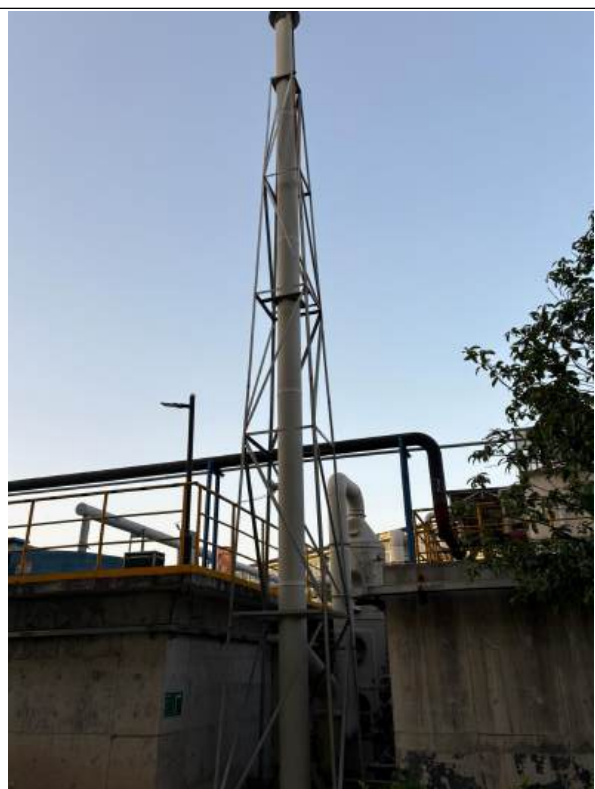
污水站、固废间喷淋装置
